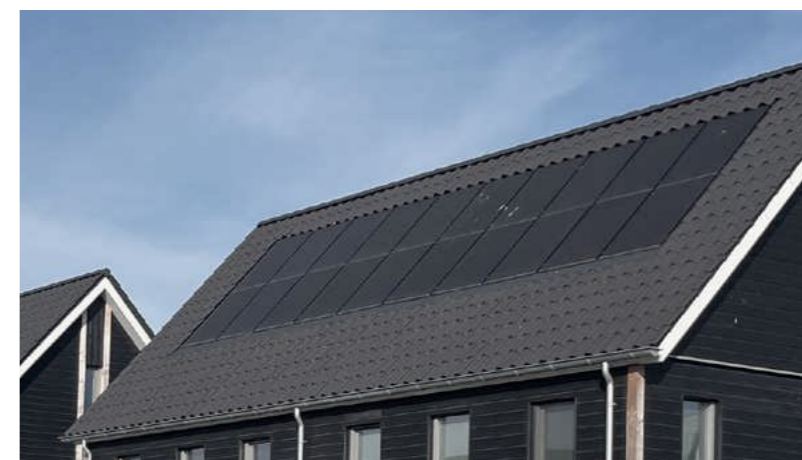
Zonnepanelen eenduidig gepositioneerd
